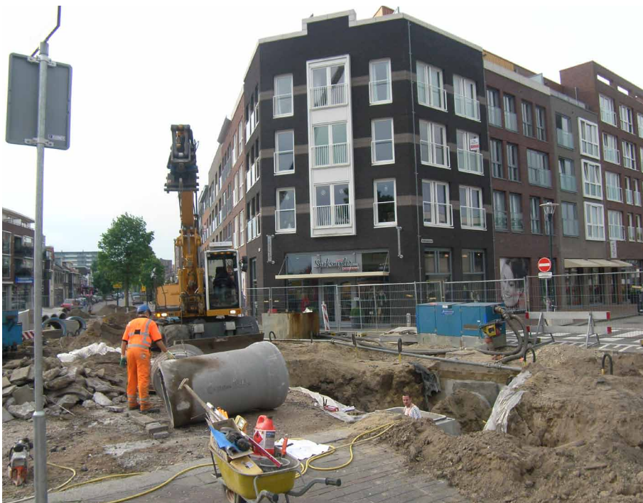
Afb. 2.3 De graafwerkzaamheden ten behoeve van de plaatsing van het nieuwe riool (werkput 2).
